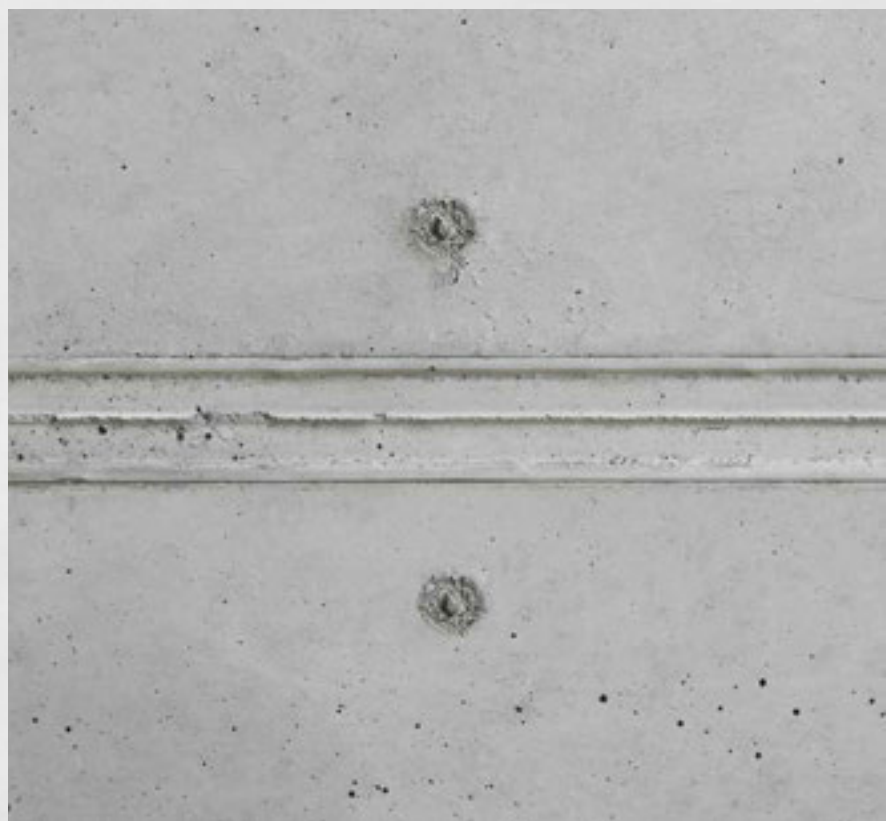
Impronta sul calcestruzzo
