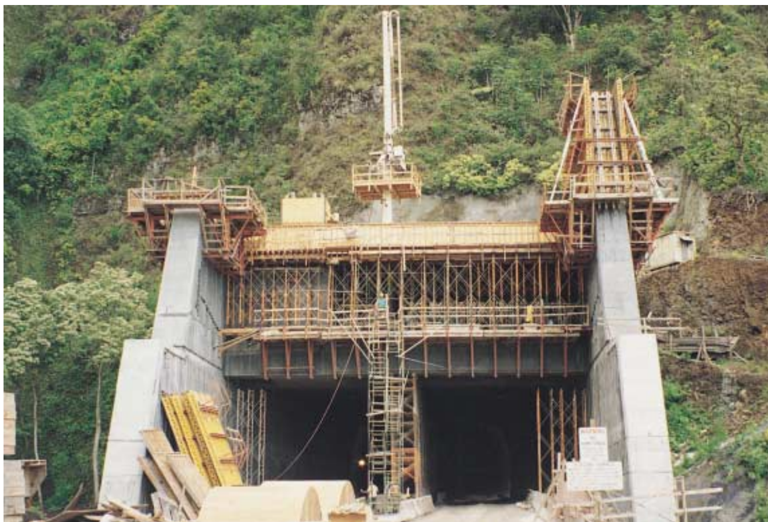
Portale della galleria Haiku realizzato con sistema VARIO abbinato alla passerella del sistema di ripresa KGF 240.
