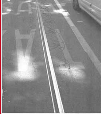
Agosto 2015 - Problemi ricorrenti nelle rotaie promiscue asfaltate
