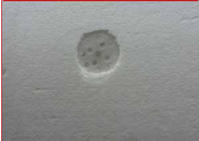
ERRORE DA EVITARE: FISSAGGIO FATTO RIENTRARE ECCESSIVAMENTE
