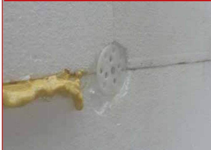
ERRORE DA EVITARE: IL TASSELLO RISULTA STORTO E ALLENTATO. È NECESSARIO RIMUOVERLO PREVEDENDO UNA NUOVA FORATURA.
