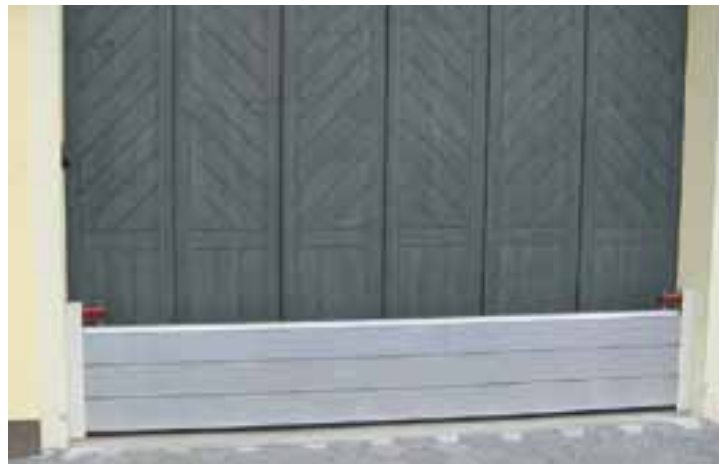
Diga PREFA a protezione del portone di un garage, con montanti di fissaggio annegati nella muratura.
