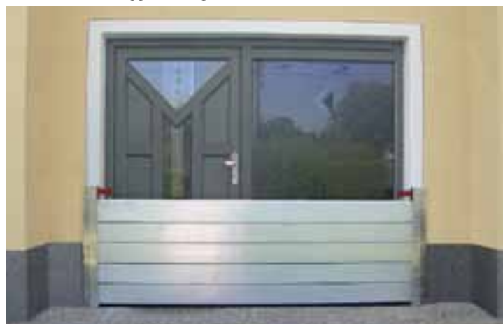
Diga PREFA a protezione del portone di un ingresso, con montanti di fissaggio installati davanti muratura.
