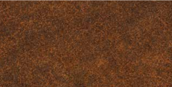
2. Aspetto/tonalità del manufatto ossidato dopo circa 4/6 mesi dall'installazione.
