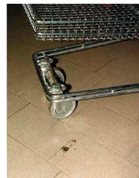
Rottura di piastrellatura sottoposta a carico concentrato
