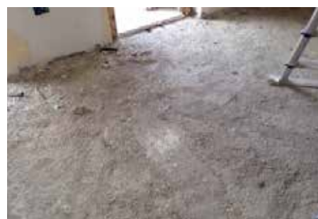
Sottofondo non idoneo alla posa del rivestimento
