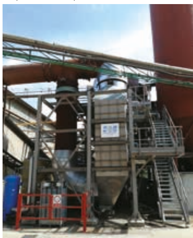
Impianto recupero calore a Rubbiano.
