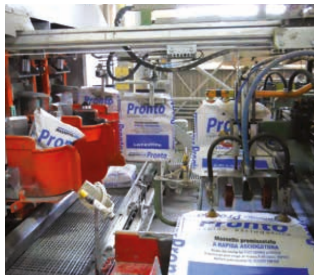
Impianto dei premiscelati nello stabilimento di Rubbiano.
