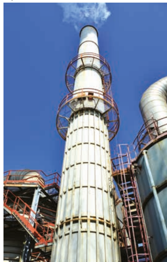
Impianti di abbattimento dei fumi.
