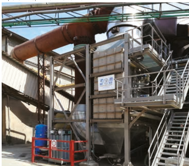
Impianto recupero calore a Rubbiano.
