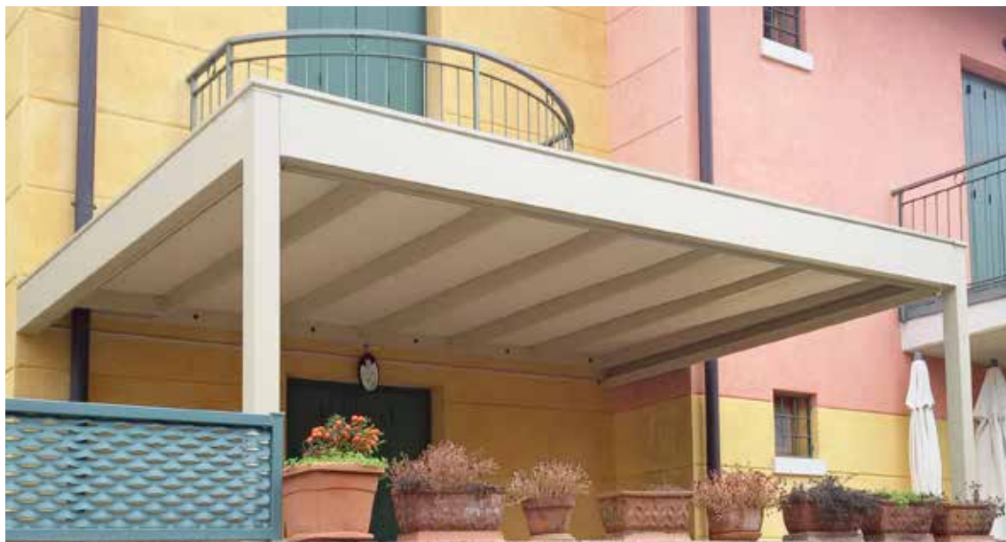
Canale raccolta acqua
