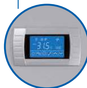
Pannello di controllo Control panel
