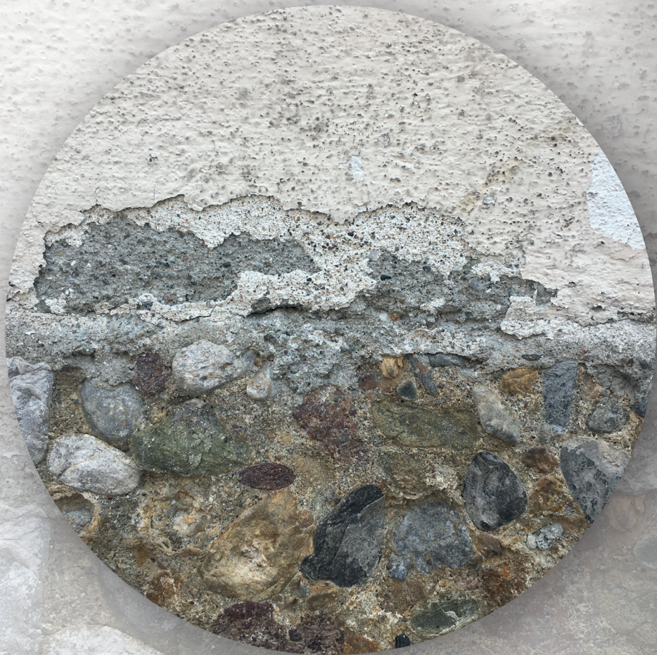
40 Strato finale dell'intonaco disgregato da efflorescenze saline subsuperficiali
