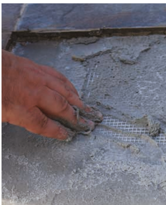
La saponificazione del manto è uno dei possibili inconvenienti riscontrabili nell'impermeabilizzazione del massetto alleggerito
