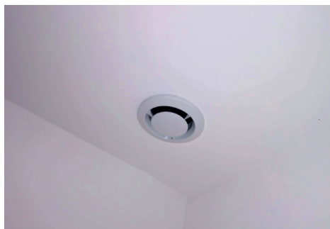
Fig. 2.5 Bocchetta di ripresa di un apparato di ventilazione meccanica centralizzato.
