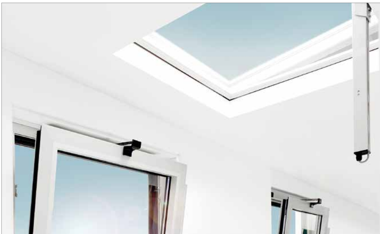
Installazione (foto: Foto Line L. Filoglou)
