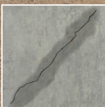
Perdite da fessure
