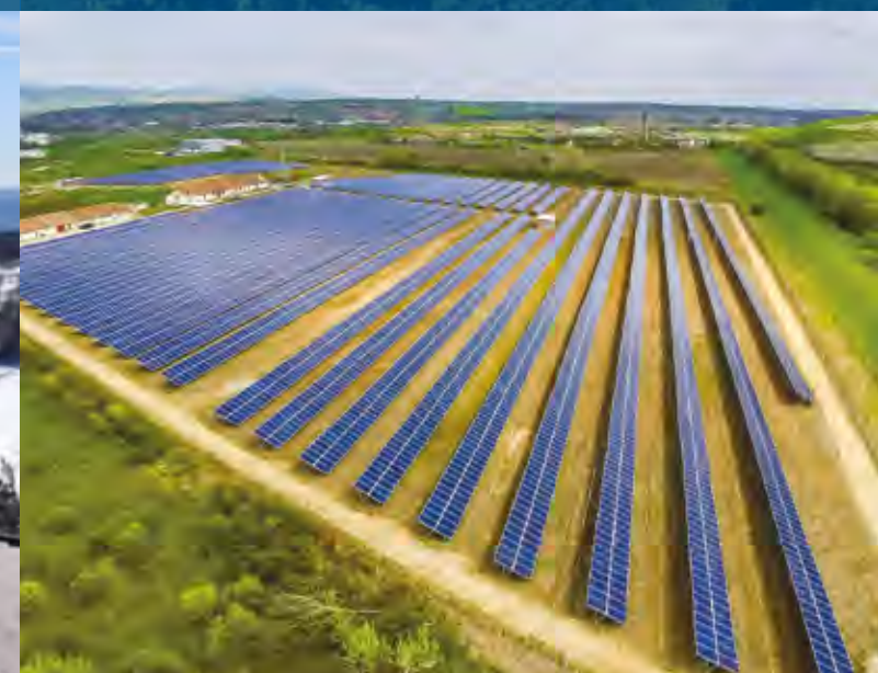
Ineu Lipova - Romania Impianto a terra FU 250 P - 4 MW
