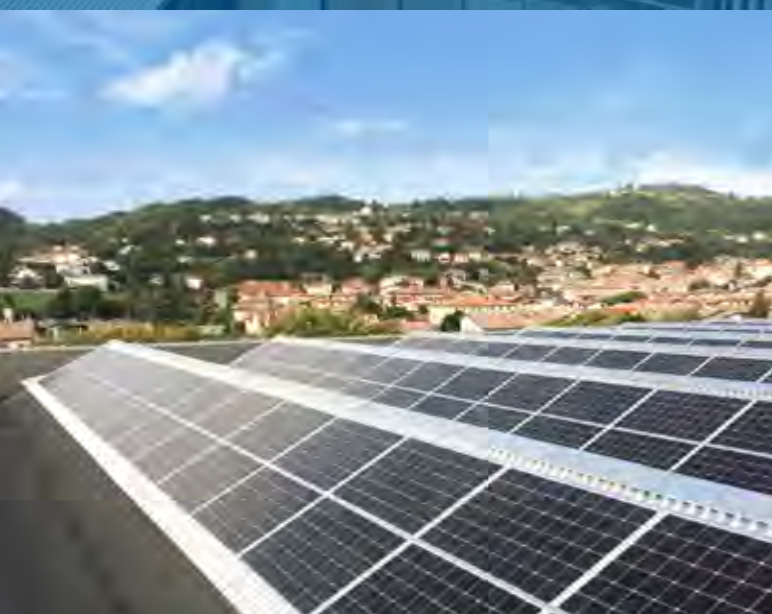
Montebello Vicentino (VI) - Italia Tetto industriale FU 300 M - 480 kWp
